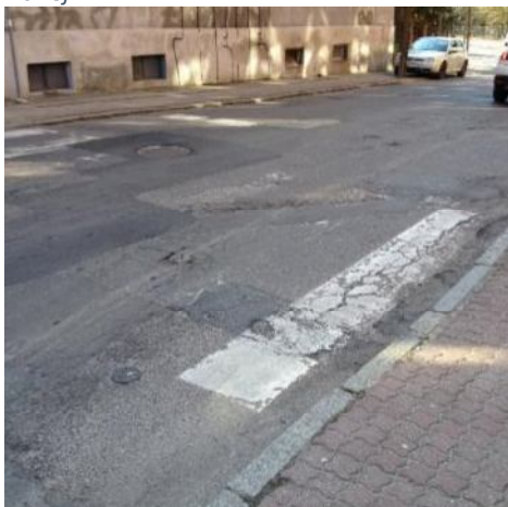
Zdjęcie 33. Nawierzchnia bitumiczna z licznymi ubytkami ul. Racławickiej
