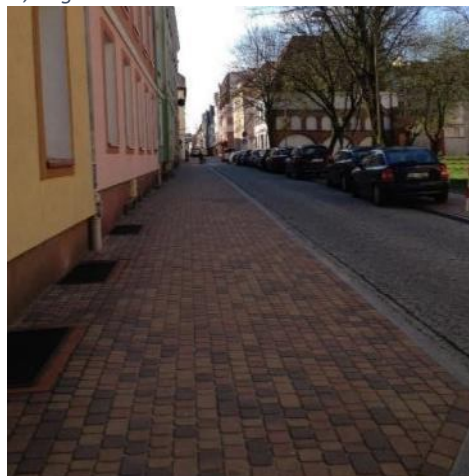
Zdjęcie 36. Ul. Bogusława II (z prawej) wyremontowane w ramach projektu pt. „Przebudowa ulic: Zawiszy Czarnego, Dąbrówki, Ks. Anastazji, Kazimierza Wielkiego, Marii Ludwicy, Bogusława II w m. Koszalin”.
