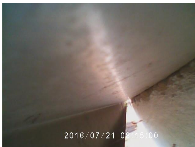
Fot. 23. Elewacja pod parapetami sprawdzona za pomocą endoskopu-brak miejsc lęgowych ptaków i bytowania nietoperzy.
