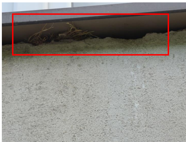
Fot. 11. Gniazdo wróbla w ubytku pod parapetem (kwadrat 2).
