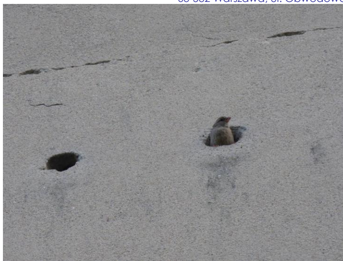
Fot. 12. Gniazdo wróbla w otworze stropodachu (kwadrat 11).
