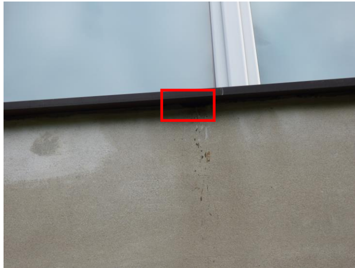
Fot. 10. Gniazdo wróbla w ubytku pod parapetem (kwadrat 1).
