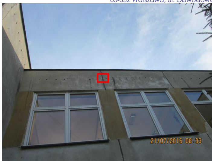
Fot. 17. Gniazdo wróbla w otworze stropodachu (kwadrat 12)
