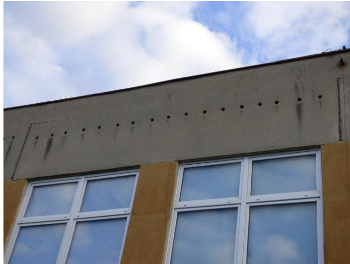
Fot. 9. Niezakratowane otwory stropodachu
