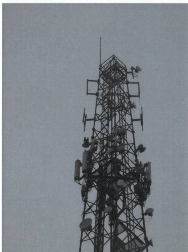
Widok instalacji radiokomunikacyjnej Stacja Netia KOSZW001 - KOSZM00001 Koszalin, ul. Morska 18A.
