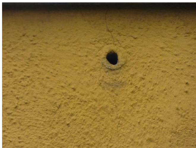
Fot. 17. Gniazdo jerzyka w otworze stropodachu (widoczne półksiężycowate ślady od ogona pod otworem) (kwadrat 2)
