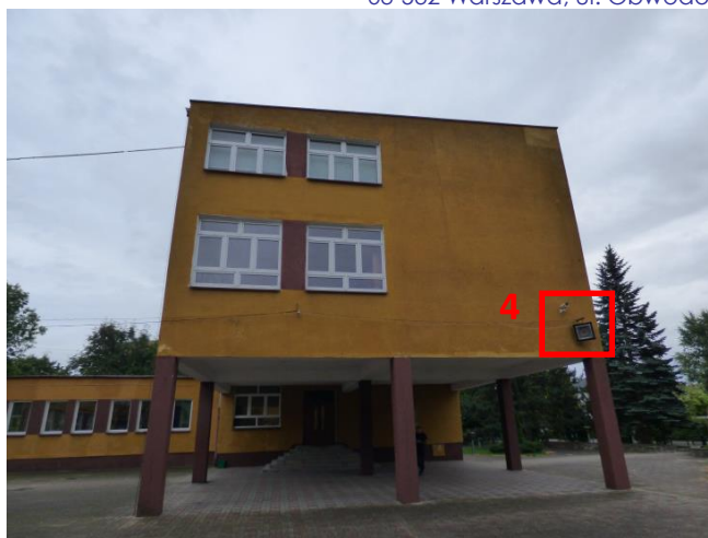
Fot. 19. Elewacja północno-zachodnia z zaznaczonymi miejscami łęgowymi (część 2) (4-mazurek).
