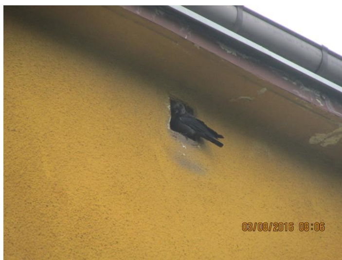
Fot. 15. Gniazdo kawki w niezakratowanym otworze stropodachu (kwadrat 1).
