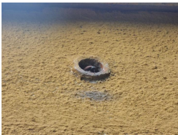
Fot. 24. Gniazdo mazurka w otworze stropodachu (kwadrat 6).
