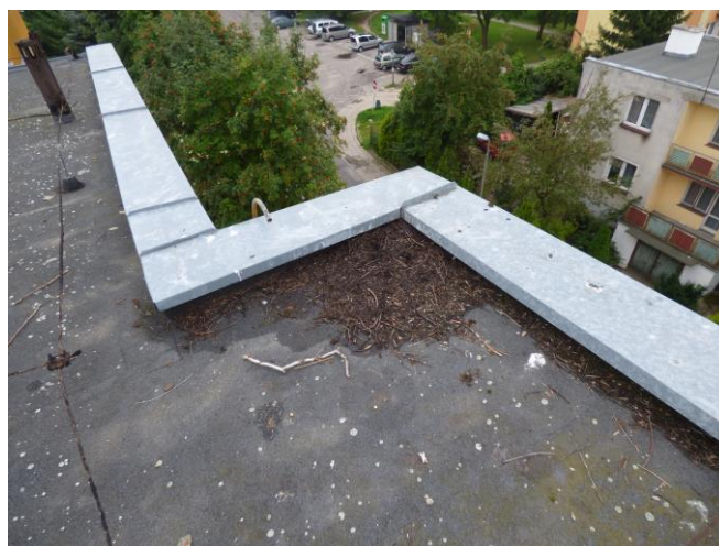
Fot. 27. Gniazdo miewy srebrzystej na dachu analizowanego budynku.
