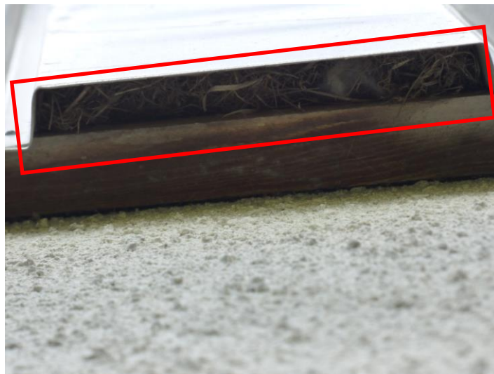
Fot. 6. Gniazdo wróbla pod blachą ścienną (kwadrat nr 1).
