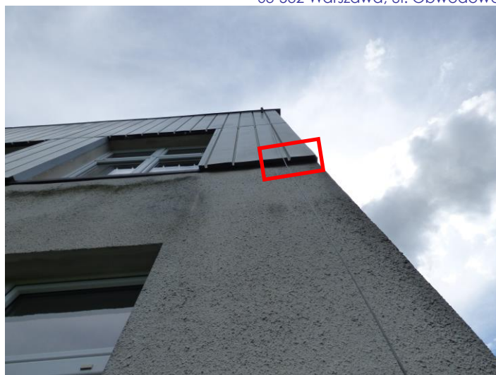
Fot. 13. Gniazdo wróbla pod blachą ścienną (kwadrat nr 11).
