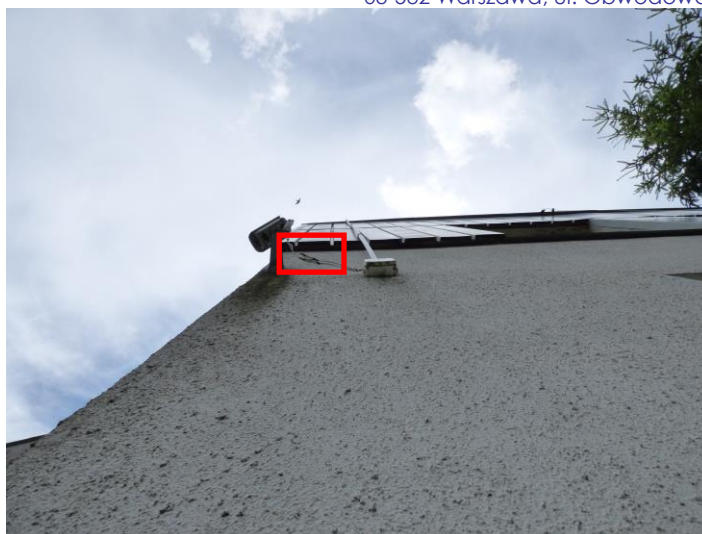
Fot. 10. Gniazdo wróbla pod blachą ścienną (kwadrat nr 5).
