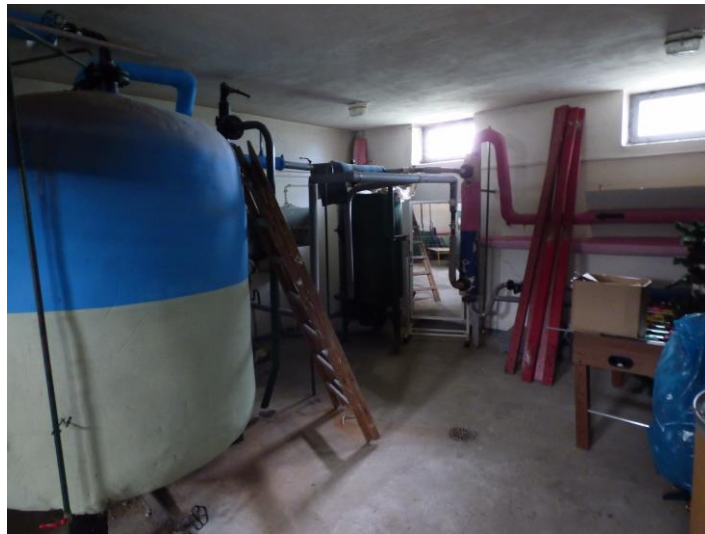
Fot. 22. Piwnica w analizowanym budynku (na zdjęciu rozdzielnia ciepła).
