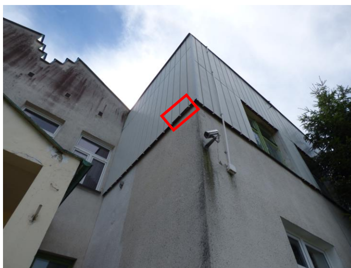
Fot. 9. Gniazdo wróbla pod blachą ścienną (kwadrat nr 4).
