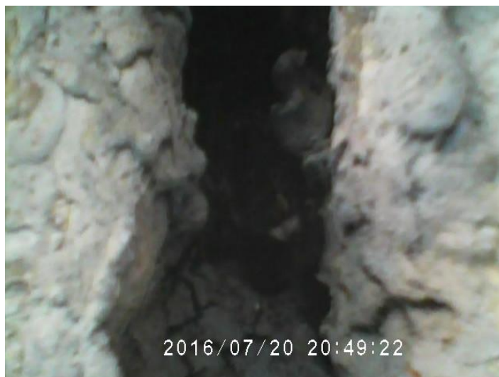
Fot. 17. Pęknięcia w elewacji-brak miejsc lęgowych ptaków i bytowania nietoperzy.
