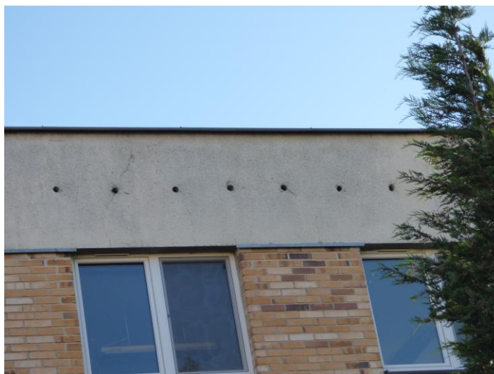
Fot. 9. Niezakratowane otwory stropodachu
