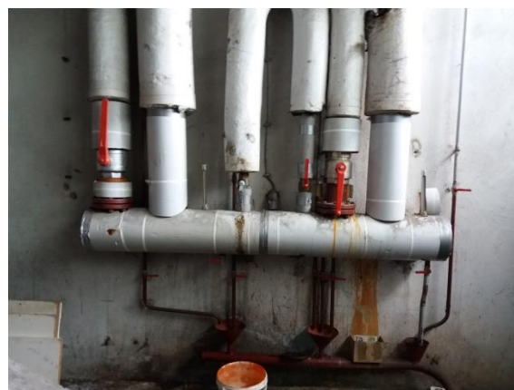
Fot. 14 Widok rozdzielacza zasilającego układ centralnego ogrzewania i nagrzewnic wodnych w systemie ogrzewania nawiewnego.
