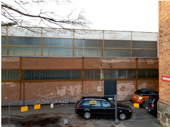
Fot. 3 Elewacja wschodnia budynku hali sportowej, odległość od budynku głównego jest mniejsza od wymaganej przepisami pożarowymi (8,00m).
