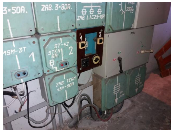
Fot. 10 C.d. widoku rozdzielni elektrycznej zlokalizowanej w maszynie wentylacyjnej hali sportowej.
