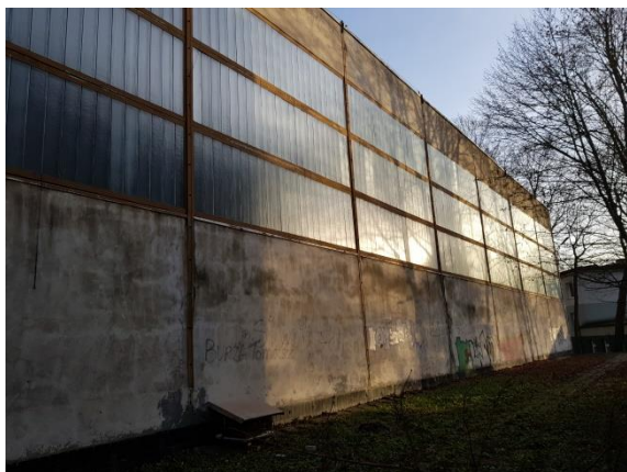
Fot. 1 Elewacja zachodnia budynku hali sportowej, widok dużej powierzchni przeszklonej panelami typu VITROLIT niespełniającymi wymagań termoizolacji i odporności ogniowej.
