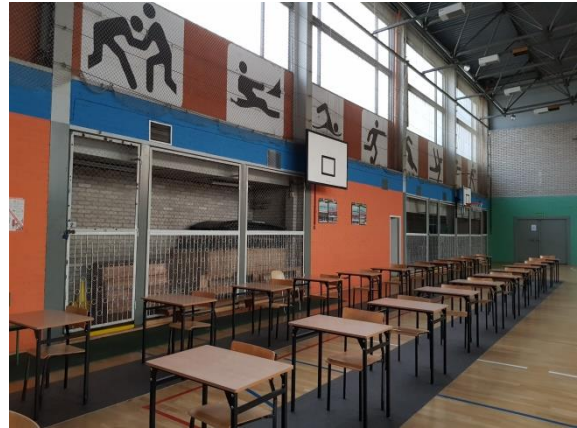
Fot. 4 Wnętrze hali sportowej (części wysokiej). Widok konstrukcji ściany wschodniej. Elementy stalowe konstrukcji szkieletowej w bardzo dobrym stanie technicznym.
