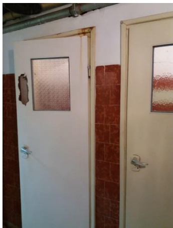
Fot. 15 Stan techniczny pomieszczeń sanitarnych zaplecza hali sportowej wymaga gruntownej modernizacji i wymiany elementów wyposażenia.
