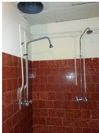
Fot. 16 Armatura sanitarna i instalacje wewnętrzne wykazują duży stopień zużycia fizycznego. Niniejsza ocena techniczna dotyczy wszystkich pomieszczeń sanitarnych zaplecza.
