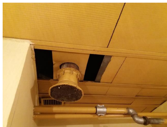
Fot. 12 Instalacja wody zimnej wykazuje wiele uszkodzeń wynikających z wad materiałowych lub ich fizycznej degradacji. Na fotografii widoczna obejma zaciskowa, założona na pęknięte miejsce.
