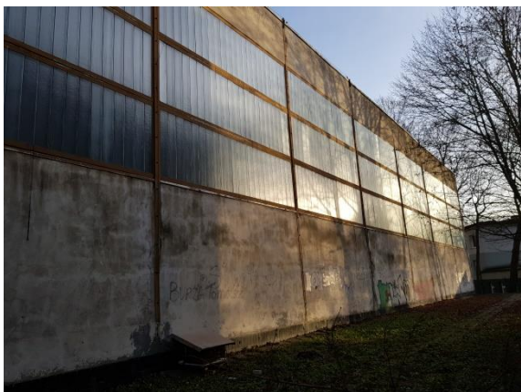
Fot. 1 Elewacja zachodnia budynku hali sportowej, widok dużej powierzchni przeszklonej panelami typu VITROLIT niespełniającymi wymagań termoizolacji i odporności ogniowej.
