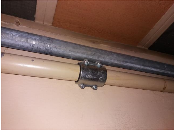
Fot. 13 Widok rozszczelnionego odcinka rury instalacji wody zimnej. Rozległy układ rurociągów wykazuje dużą ilość wykonanych napraw.
