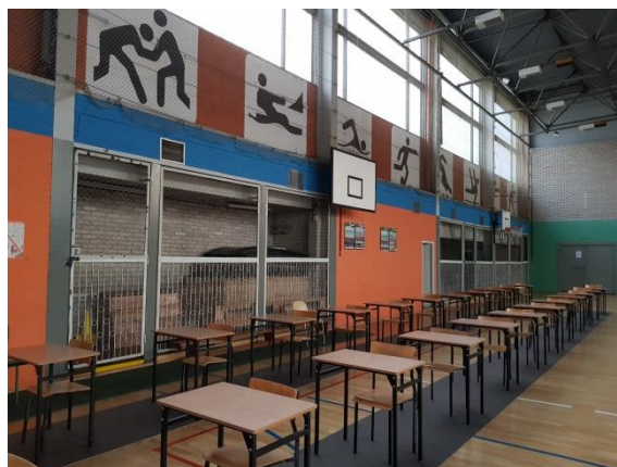
Fot. 4 Wnętrze hali sportowej (części wysokiej). Widok konstrukcji ściany wschodniej. Elementy stalowej konstrukcji szkieletowej w bardzo dobrym stanie technicznym.
