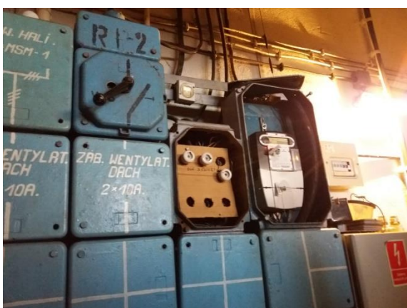
Fot. 9 Widok głównej rozdzielni elektrycznej obsługującej wentylatory nawiewne i pozostałe odbiorniki hali sportowej. Zaawansowany stan zużycia technicznego.
