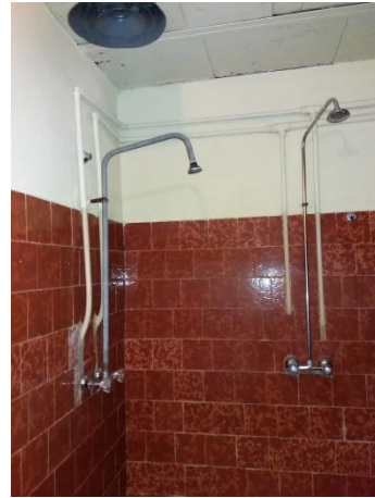
Fot. 16 Armatura sanitarna i instalacje wewnętrzne wykazują duży stopień zużycia fizycznego. Niniejsza ocena techniczna dotyczy wszystkich pomieszczeń sanitarnych zaplecza.
