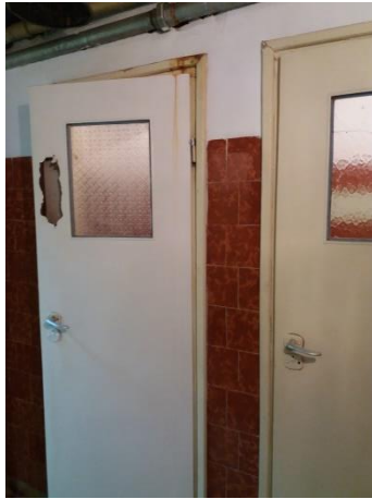
Fot. 15 Stan techniczny pomieszczeń sanitarnych zaplecza hali sportowej wymaga gruntownej modernizacji i wymiany elementów wyposażenia.
