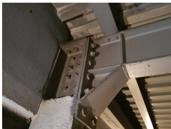
Fot. 6 Węzeł połączenia słupa z podciągami stalowej konstrukcji zaplecza hali sportowej (niska część). Elementy połączeniowe i węzeł nie wykazują odkształceń, przemieszczeń lub korozji.
