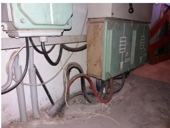
Fot. 11 Stan techniczny przyłącza energetycznego hali sportowej wymaga modernizacji i przebudowy. Niejasny sposób zasilania rozdzielni (dwie linie zasilające) wywołuje chaos formalny.
