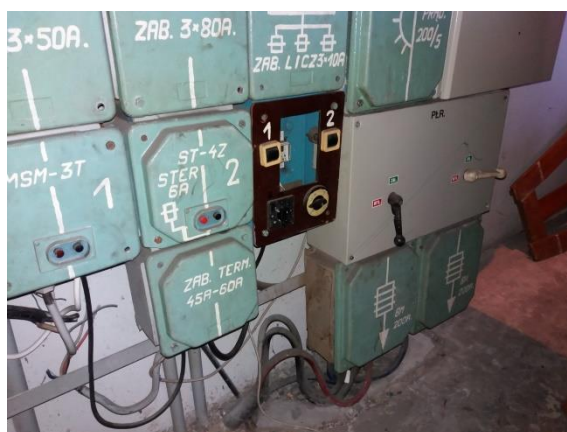
Fot. 10 C.d. widoku rozdzielni elektrycznej zlokalizowanej w maszynowni wentylacyjnej hali sportowej.
