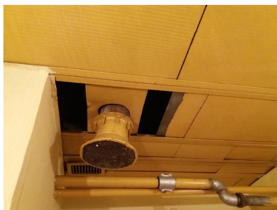
Fot. 12 Instalacja wody zimnej wykazuje wiele uszkodzeń wynikających z wad materiałowych lub ich fizycznej degradacji. Na fotografii widoczna obejma zaciskowa, założona na pęknięte miejsce.
