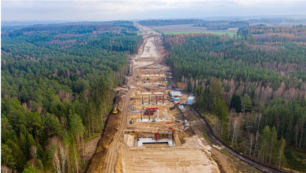
S11 – Budowa odcinka trasy ekspresowej S11 Koszalin – Bobolice. Stan na koniec 2021 r. Źródło: GDDKiA O. Szczecin
