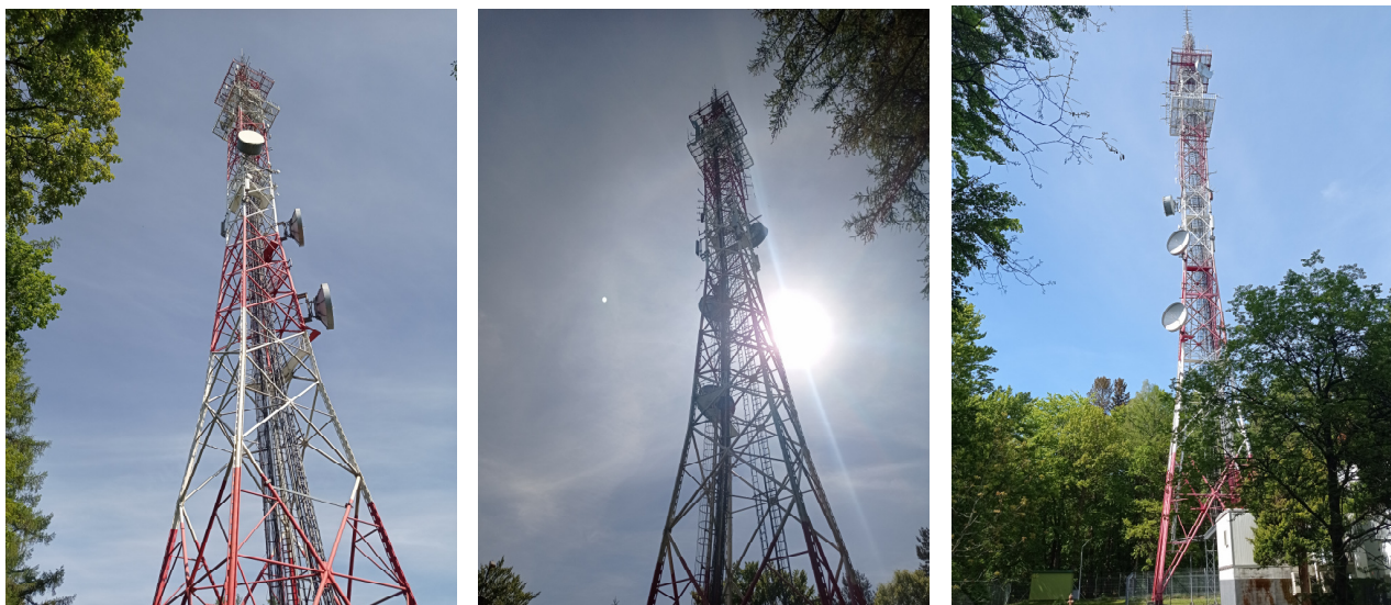
Widok obiektu wraz z zainstalowanym zespołem antenowym
