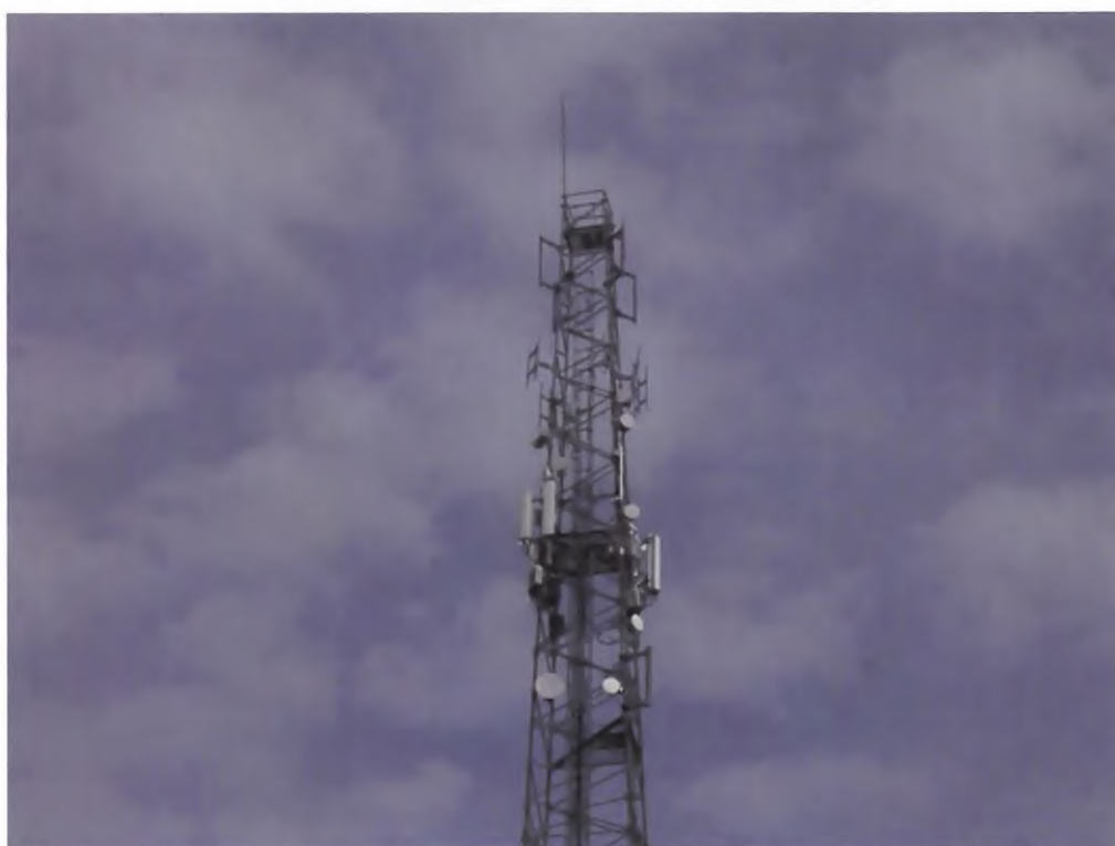
Widok instalacji radiokomunikacyjnej Stacja Netia KOSZW001 - KOSZM00001 Koszalin, ul. Morska 18A.
