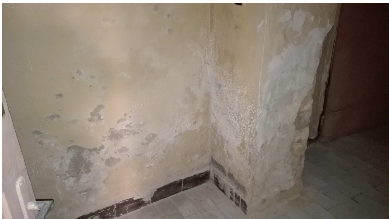
Widoczna degradacja tynków na ścianach piwnic.
