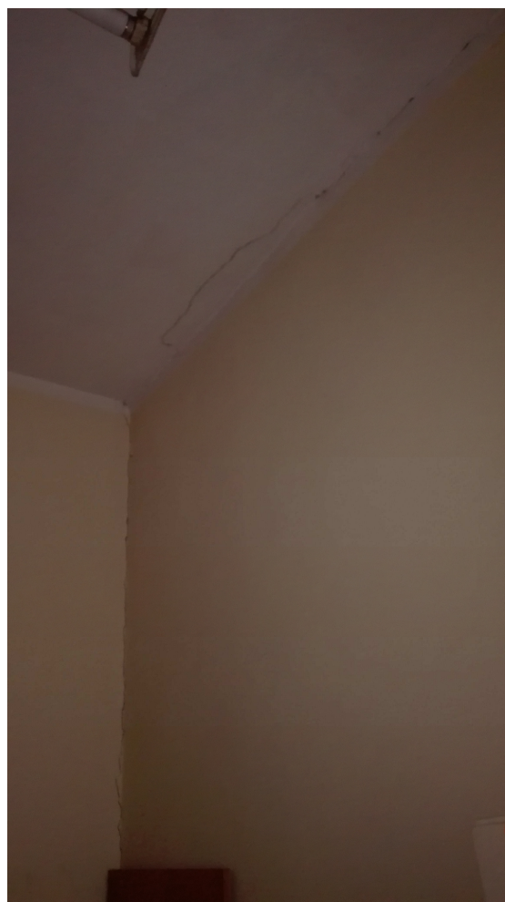
Zarysowanie w narożniku stropu nad parterem ze ścianą szczytową.
