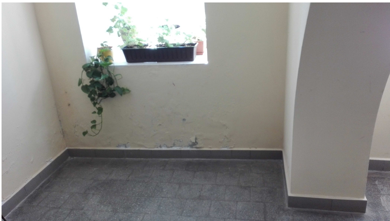
Pomieszczenie szatni po remoncie - widoczny brak należytej izolacji i podsiąkanie wilgoci.
