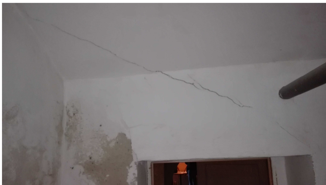
Widoczne zawilgocenie ścian oraz zarysowana ścian i stropu nad piwnicą.
