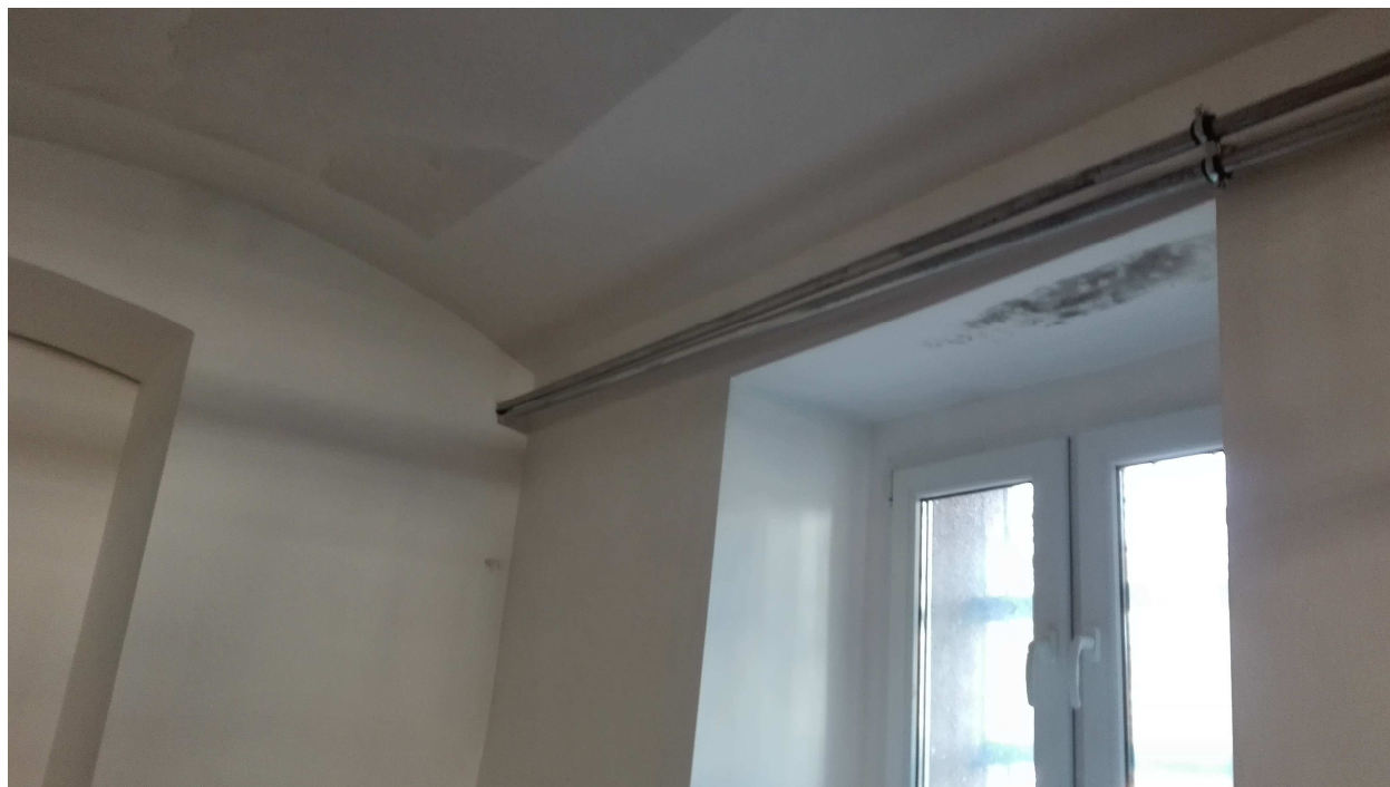
Brak odpowiedniej wentylacji powoduje powstawanie grzyba w górnej strefie pomieszczeń piwnicznych.
