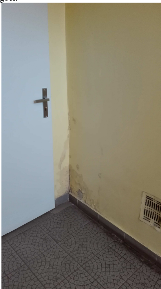
Przy wejściu do szatni widoczny wpływ wilgoci mimo niedawnego remontu.
