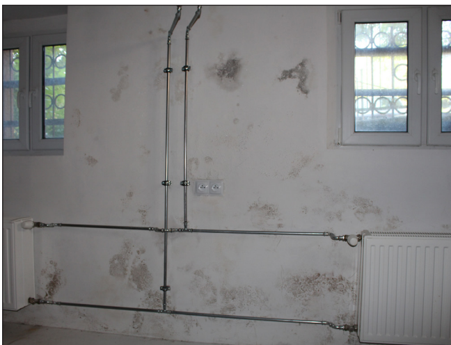
fot. 16. Kuchnia - widoczne skażenie mikrobiologiczne oraz wykwity solne, stan 2020 rok. fot. M. Caban
