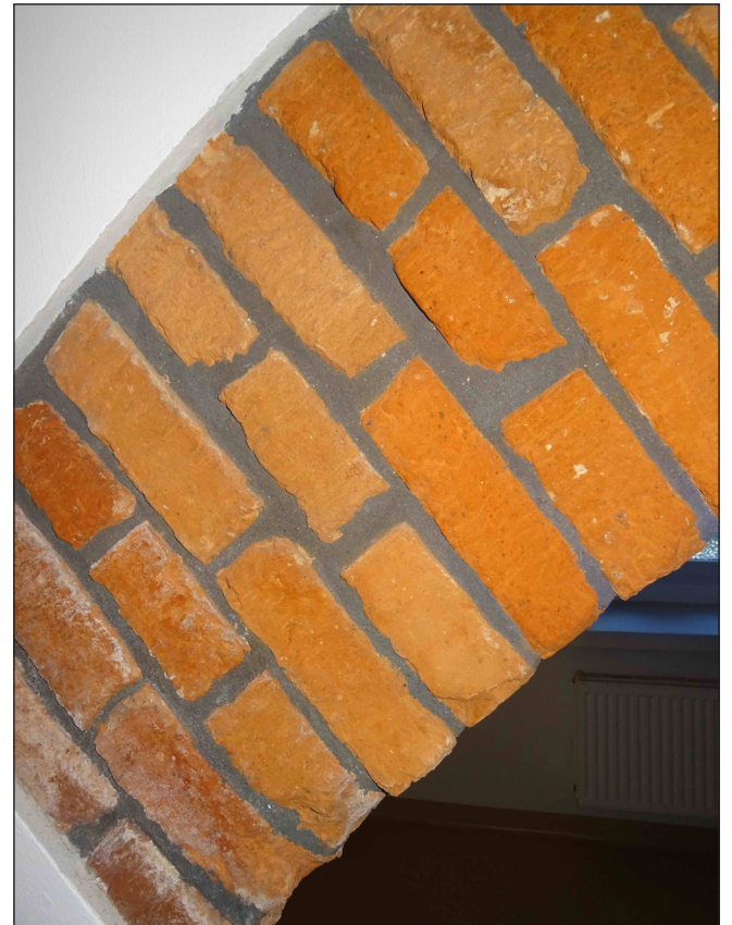
fot. 42. Sala fitness - odsłonięty łuk ceglany - wyspoinowany szczelną zaprawą cementową, widoczne wykwity solne na ceglach, stan 2020 rok. fot. M. Caban
