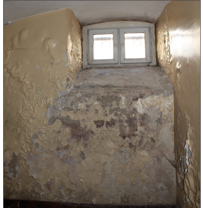
fot. 24. Ściana od ulicy Krzywoustego - widoczne zawilgocenie ściany, wykwity solne, łuszczące się farby oraz skażenie mikrobiologiczne, stan 2020 rok. fot. M. Caban
