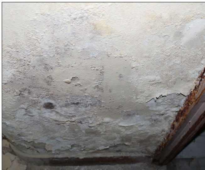
fot. 33. Dezintegracja tynku, wykwity solne, złuszczenie się farb oraz silne skażenie mikrobiologiczne, metalowa futryna całkowicie zardzewiała od panującej w pomieszczeniu wilgoci, stan 2020 rok. fot. M. Caban
