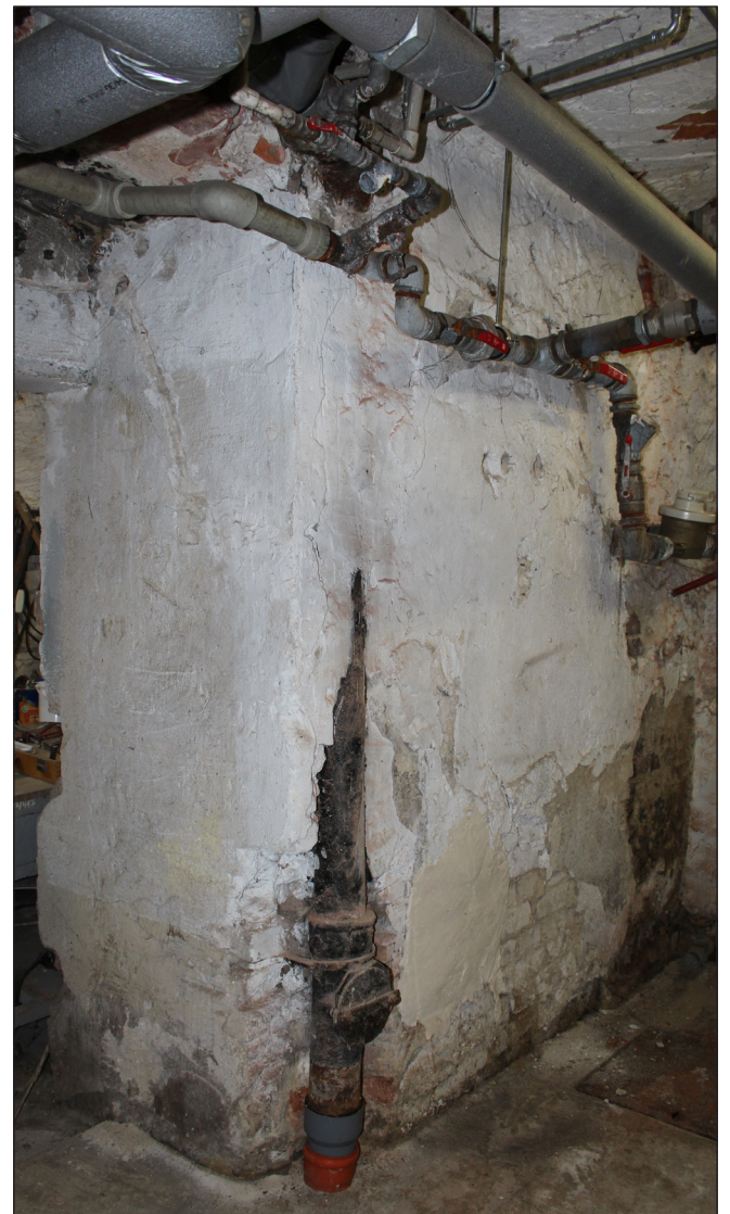
fot. 52. Kotłownia - niedrożna instalacja kanalizacyjna, stan 2020 rok. fot. M. Caban
