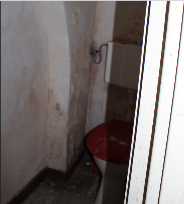
fot. 23. Silne zawilgocenie ściany oraz skażenie mikrobiologiczne powstałe prawdopodobnie w wyniku podciągania kapilarnego wody z gruntu, stan 2020 rok. fot. M. Caban
