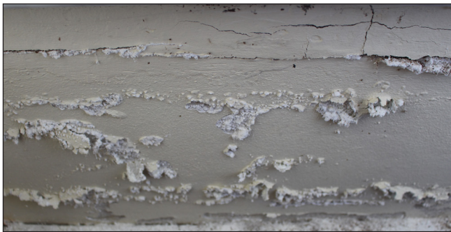
fot. 43. Zawilgocenie ściany, wynikające prawdopodobnie z podciągania kapilarnego wody z gruntu oraz braku możliwości odparowania wilgoci na zewnątrz (tynk epoksydowy), spowodowało dezintegrację tynku i wykwyty solne, stan 2020 rok. fot. M. Caban
