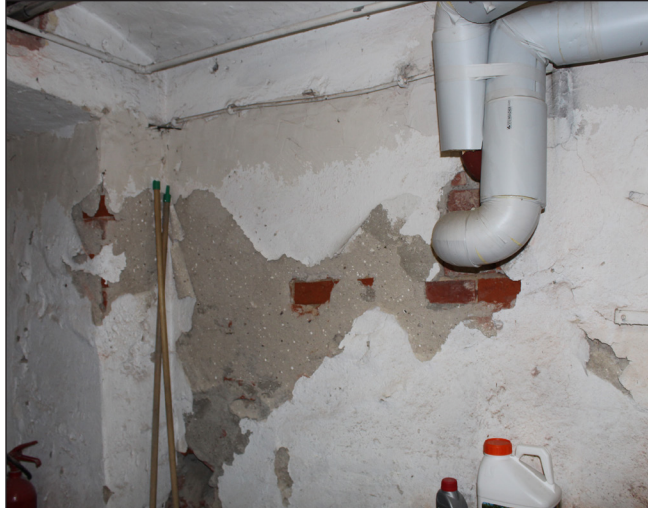
fot. 48. Kotłownia - wykwity solne oraz silne skażenie mikrobiologiczne, stan 2020 rok. fot. M. Caban
