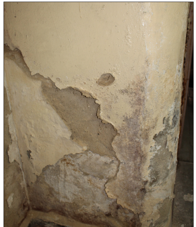
fot. 31. Zawilgocenie ściany, wynikające prawdopodobnie z podciągania kapilarnego wody z gruntu, spowodowało dezintegrację tynku, wykwyty solne, złuszczenie się farb oraz silne skażenie mikrobiologiczne, stan 2020 rok. fot. M. Caban
