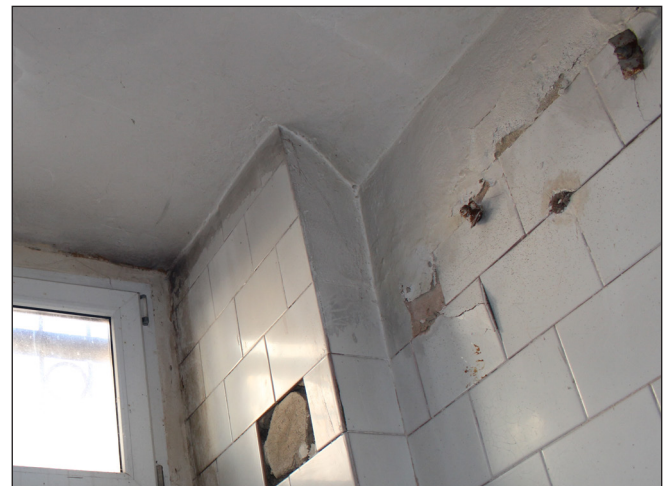
fot. 19. Kuchnia - widoczne wykwity solne oraz skażenie mikrobiologiczne powyżej poziomu kafelek, w miejscu pęknięcia kafelki naprężenia soli są tak duże że płytka została wypchnięta od ściany stan 2020 rok. fot. M. Caban
