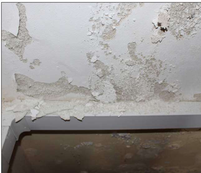
fot. 45. Zawilgocenie ściany, wynikające prawdopodobnie z podciągania kapilarnego wody z gruntu, spowodowało dezintegrację tynku, wykwyty solne, złuszczenie się farb oraz silne skażenie mikrobiologiczne, stan 2020 rok. fot. M. Caban
