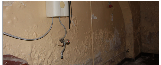
fot. 27. Zawilgocenie ściany, wykwity solne, łuszczące się farby oraz skażenie mikrobiologiczne, stan 2020 rok. fot. M. Caban
