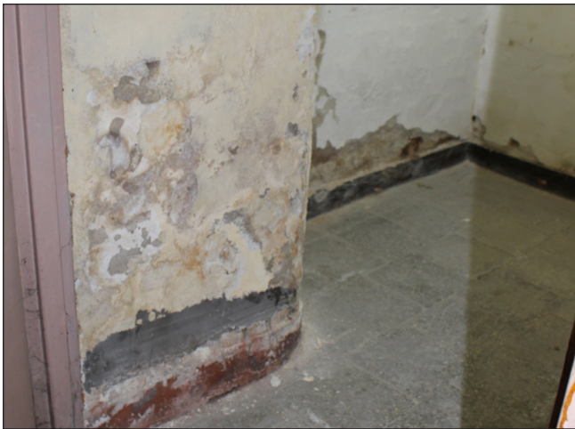
fot. 28. Zawigocenie ściany, wykwyty solne, łuszczące się farby oraz skażenie mikrobiologiczne, stan 2020 rok. fot. M. Caban
