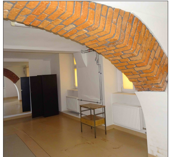
fot. 41. Sala fitness - odsłonięty łuk ceglany - wyspoinowany szczelną zaprawą cementową stan 2020 rok. fot. M. Caban
