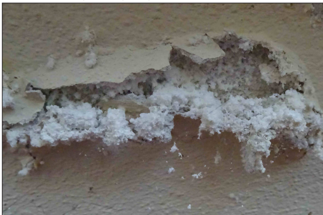
fot. 44. Dezintegracja tynku oraz wykwyty solne, stan 2020 rok. fot. M. Caban
