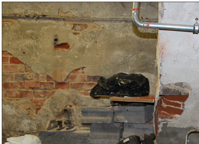
fot. 50. Kotłownia - wykwity solne oraz silne skażenie mikrobiologiczne, stan 2020 rok. fot. M. Caban
