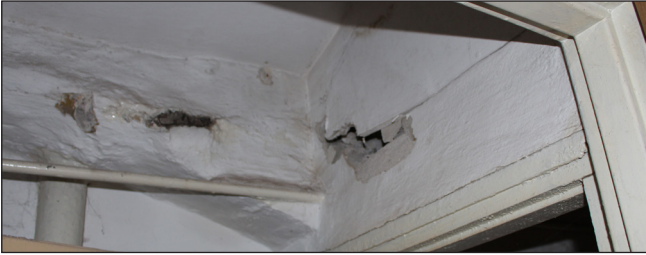
fot. 21. Dezintegracja tynku wynikająca prawdopodobnie z nieszczelnej instalacji kanalizacyjnej, stan 2020 rok. fot. M. Caban
