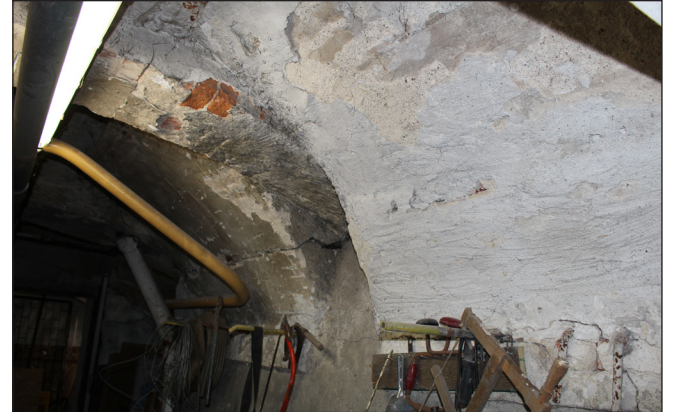
fot. 51. Kotłownia - wykwity solne oraz silne skażenie mikrobiologiczne, stan 2020 rok. fot. M. Caban
