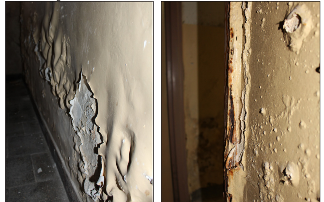
fot. 25,26. Widoczne, wykwity solne, łuszczące się farby oraz skażenie mikrobiologiczne, metalowa futrna całkowicie zardzewiała od panującej w pomieszczeniu wilgoci, stan 2020 rok. fot. M. Caban
