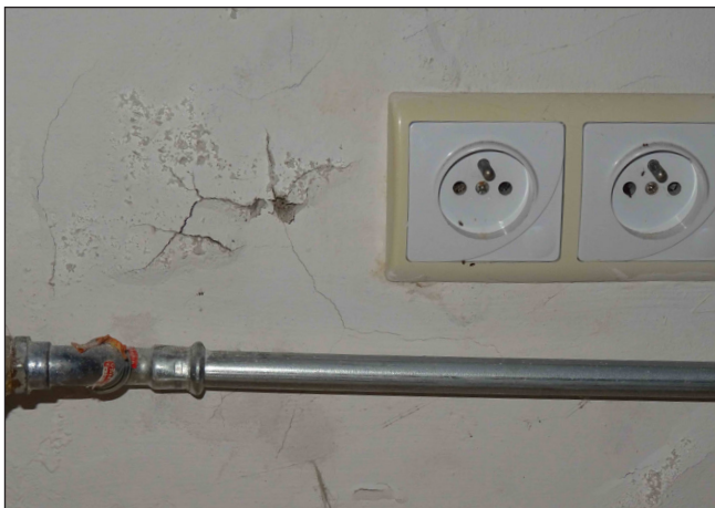
fot. 40. Sala fitness - wykwity solne oraz silne skażenie mikrobiologiczne mimo założenia tynków odsalających oraz założenia izolacji pionowej wzdłuż pomieszczenia, stan 2020 rok. fot. M. Caban
