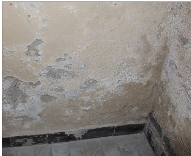
fot. 34. Zawilgocenie ściany, wynikające prawdopodobnie z podciągania kapilarnego wody z gruntu, wykwity solne oraz silne skażenie mikrobiologiczne, stan 2020 rok. fot. M. Caban
