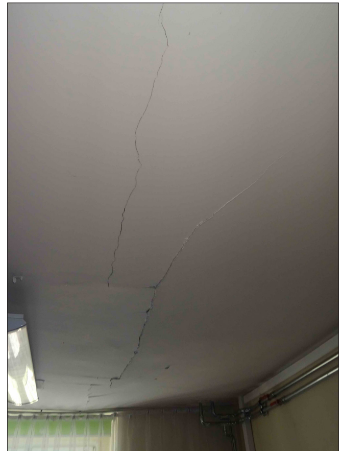
fot. 46. Strukturalne pęknięcie sufitu w pomieszczeniu biurowym, stan 2020 rok. fot. M. Caban
