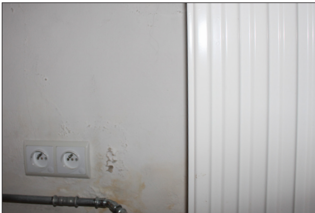
fot. 39. Sala fitness - wykwity solne oraz silne skażenie mikrobiologiczne mimo założenia tynków odsalających oraz założenia izolacji pionowej wzdłuż pomieszczenia, stan 2020 rok. fot. M. Caban
