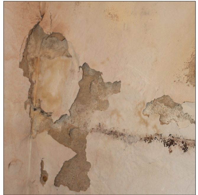
fot. 30. Dezintegracja tynku, wykwyty solne, złuszczenie się farb oraz silne skażenie mikrobiologiczne, stan 2020 rok. fot. M. Caban
