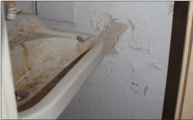
fot. 22. Ściana przy umywalce w pomieszczeniu WC - widoczne zawilgocenie ściany, łuszczące się farby oraz skażenie mikrobiologiczne, stan 2020 rok. fot. M. Caban
