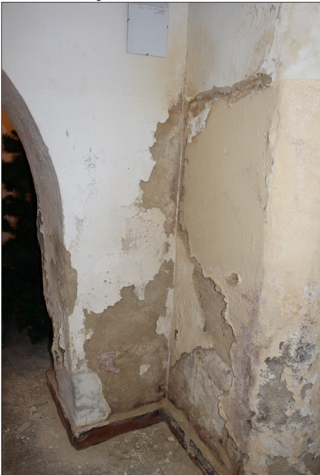
fot. 29. Zawilgocenie ściany, wynikające prawdopodobnie z podciągania kapilarnego wody z gruntu, spowodowało dezintegrację tynku, wykwyty solne, złuszczenie się farb oraz silne skażenie mikrobiologiczne, stan 2020 rok. fot. M. Caban
