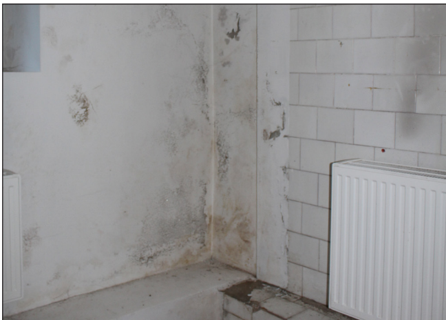
fot. 15. Kuchnia - widoczne skażenie mikrobiologiczne, stan 2020 rok. fot. M. Caban
