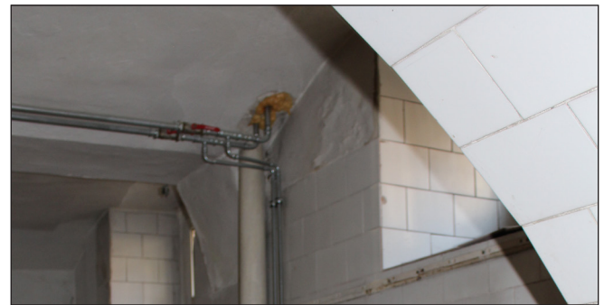
fot. 18. Kuchnia - widoczne wykwity solne powyżej poziomu kafelek, stan 2020 rok. fot. M. Caban
