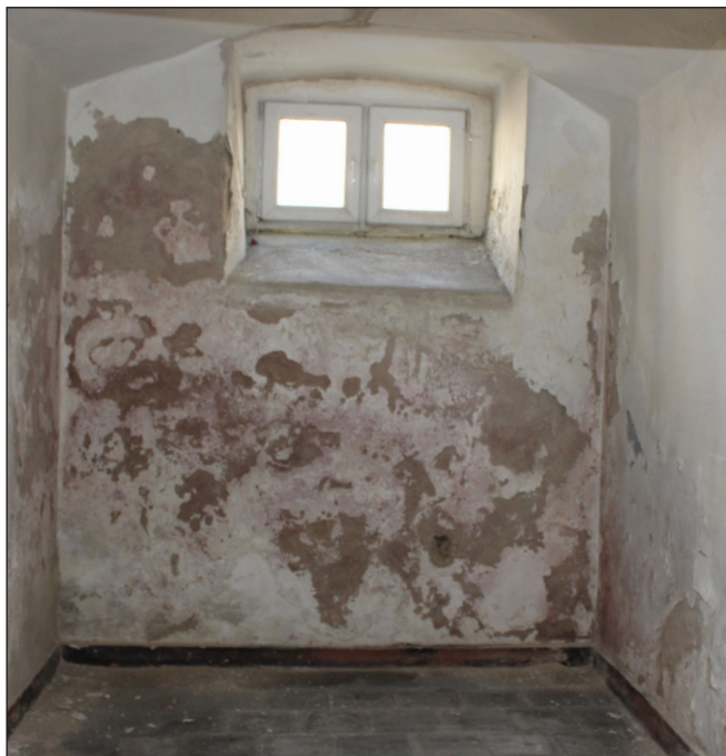
fot. 32. Ściana od ulicy Krzywoustego - widoczne zawilgocenie ściany, wykwity solne, łuszczące się farby oraz silne skażenie mikrobiologiczne, stan 2020 rok. fot. M. Caban
