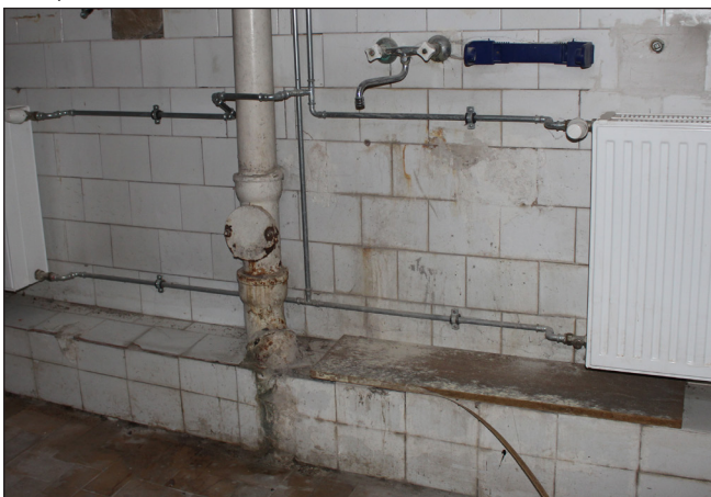
fot. 17. Kuchnia - rura spustowa kanalizacji, widoczne przedziewienia świadczące o nieszczelności instalacji, stan 2020 rok. fot. M. Caban
