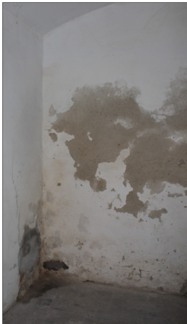
fot. 37. Zawilgocenie ściany, wynikające prawdopodobnie z podciągania kapilarnego wody z gruntu, spowodowało dezintegrację tynku, wykwity solne, złuszczenie się farb oraz silne skażenie mikrobiologiczne, stan 2020 rok. fot. M. Caban
