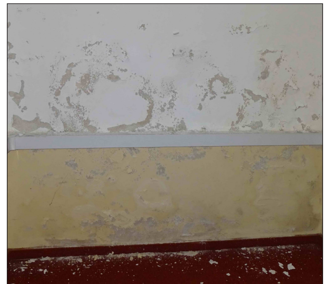
fot. 47. Zawilgocenie ściany spowodowało dezintegrację tynku, wykwyty solne, złuszczenie się farb oraz silne skażenie mikrobiologiczne, stan 2020 rok. fot. M. Caban
