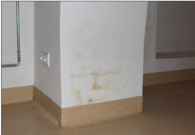
fot. 38. Sala fitness - wykwity solne oraz silne skażenie mikrobiologiczne mimo założenia tynków odsalających oraz założenia izolacji pionowej wzdłuż pomieszczenia, stan 2020 rok. fot. M. Caban
