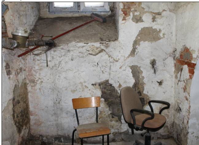
fot. 49. Kotłownia - ściana od strony ulicy Krzywoustego, wykwity solne oraz silne skażenie mikrobiologiczne, stan 2020 rok. fot. M. Caban
