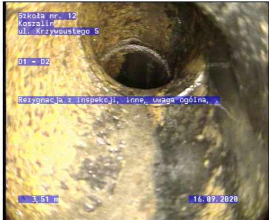
Zdj cie: 1_1_2_29092020_134629_A.jpg, 00:01:03 3,51m, Rezygnacja z inspekcji, inne, uwaga ogólna, . / .
