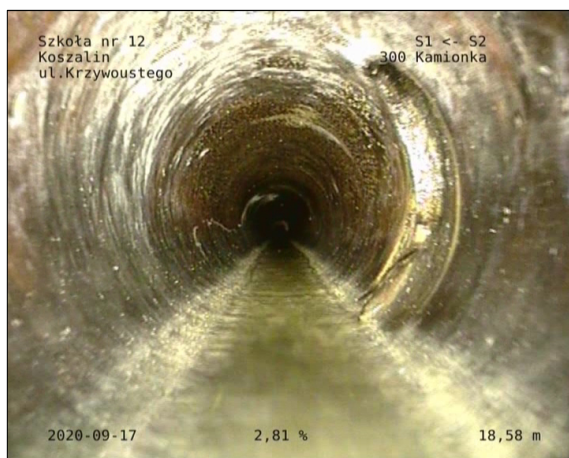
Zdjęcie: 1_1_3_29092020_142801_A.jpg, 00:03:23 19,11m, Przyłącze otwarte, Wysokość przewodu przyłączeniowego: 150 mm, Szerokość przewodu przyłączeniowego: 150 mm, na 2 godz.
