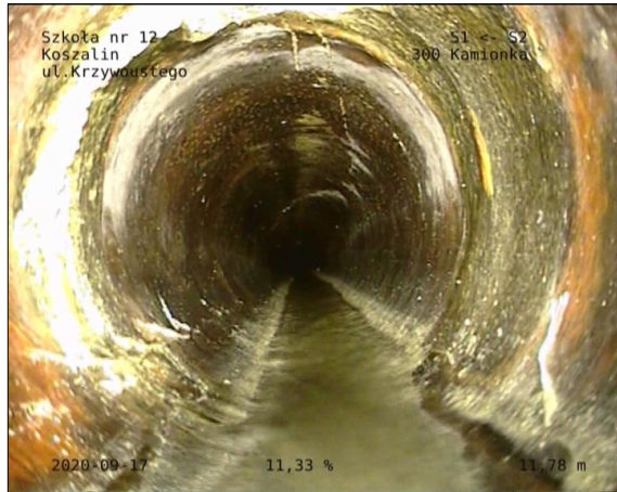
Zdjęcie: 1_1_2_29092020_142706_A.jpg, 00:02:13 11,85m, Przyłącze otwarte, Wysokość przewodu przyłączeniowego: 150 mm, Szerokość przewodu przyłączeniowego: 150 mm, na 12 godz.
