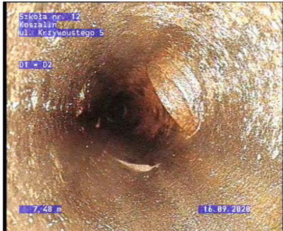
Zdjęcie: 2_1_2_29092020_134753_A.jpg, 00:01:52 7,84m, Poł czenie, ł cznik, przył cze otwarte, 100 mm wysoki, 100 mm szeroki, przy 9 godz.
