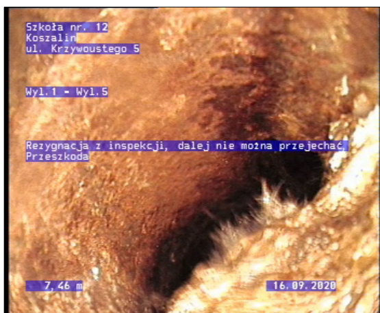
Zdjęcie cie: 6_1_7_29092020_145515_A.jpg, 00:02:59 7,46m, Rezygnacja z inspekcji, dalej nie można przejechać, Przeszkoda / Przeszkoda
