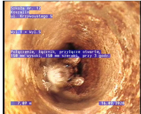
Zdjęcie cie: 6_1_6_29092020_145503_B.jpg, 00:02:19 7,09m, Poł czenie, ł cznik, przył cze otwarte, 150 mm wysoki, 150 mm szeroki, przy 3 godz.
