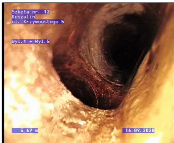
Zdjęcie: 6_1_3_29092020_145331_A.jpg, 00:01:01 5,72m, Poł czenie, ł cznik, przył cze otwarte, 150 mm wysoki, 150 mm szeroki, przy 3 godz.
