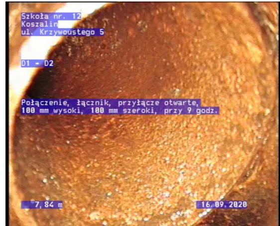
Zdjęcie: 2_1_2_29092020_134812_B.jpg, 00:01:52 7,84m, Poł czenie, ł cznik, przył cze otwarte, 100 mm wysoki, 100 mm szeroki, przy 9 godz.
