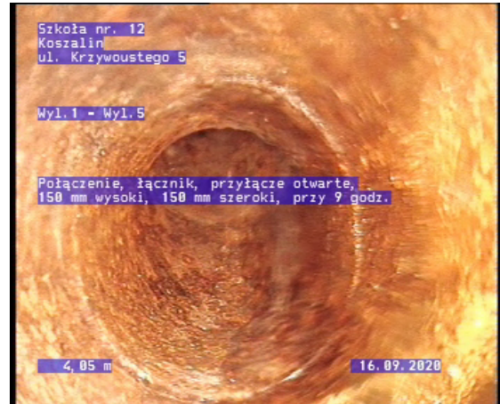
Zdjęcie: 6_1_2_29092020_145250_B.jpg, 00:00:31 4,05m, Poł czenie, ł cznik, przył cze otwarte, 150 mm wysoki, 150 mm szeroki, przy 9 godz.
