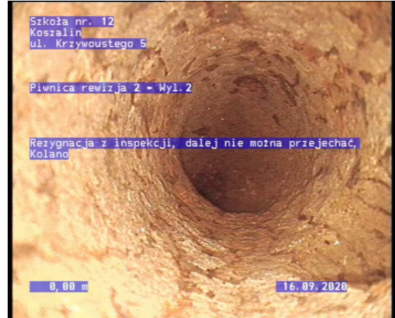
Zdjęcie: 10_1_2_29092020_145844_A.jpg, 00:00:21 0m, Rezygnacja z inspekcji, dalej nie można przejechać, Kolano / Kolano
