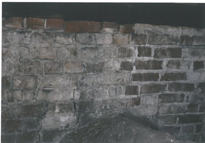
7. Gotycka kaplica św. Gertrudy, poddasze, lico muru pokryte białymi wysoleniami, z wyraźnie widocznym pęknięciem.
