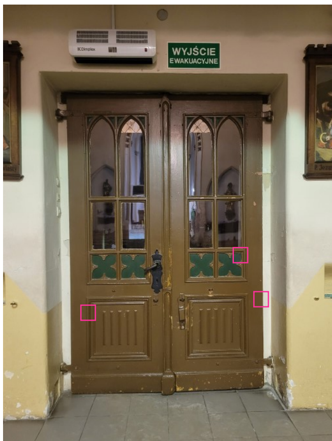
fot. 36. Kościół pw. św. Józefa Oblubieńca NMP w Koszalinie, drzwi wewnętrzne w kruchcie pod wieżą, widok od strony nawy głównej.
