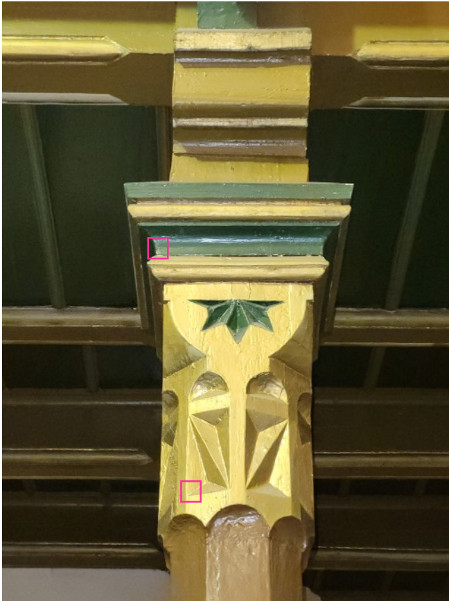
fot. 40. Kościół pw. św. Józefa Oblubieńca NMP w Koszalinie, wewnątrz kościoła, filar empory muzycznej.
