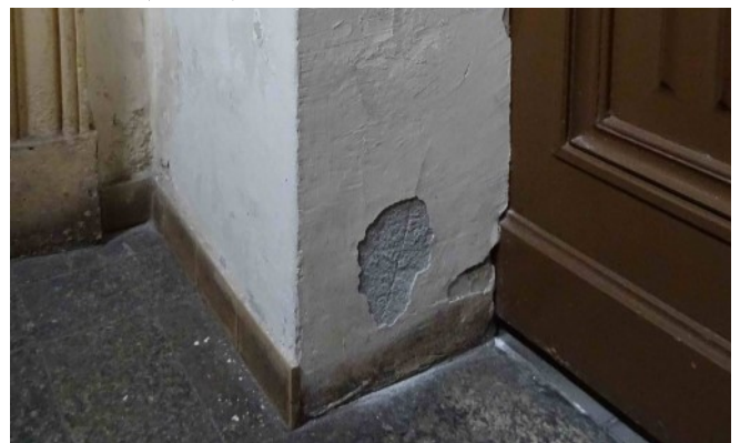
fot. 28. Kościół pw. św. Józefa Oblubieńca NMP w Koszalinie, uszkodzone tynki przyziemia.
