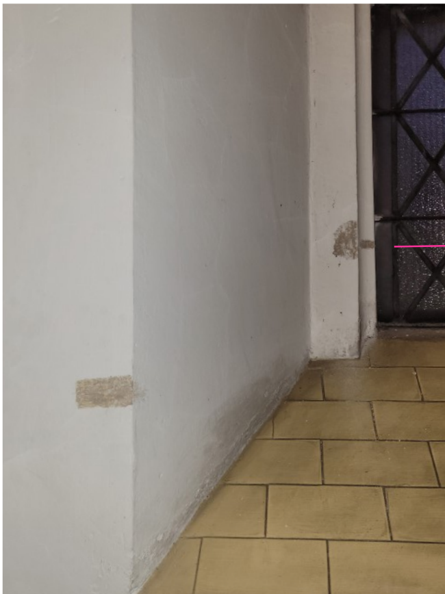
fot. 65. Kościół pw. św. Józefa Oblubieńca NMP w Koszalinie, odkrywki w glicie okiennym nawy głównej.
