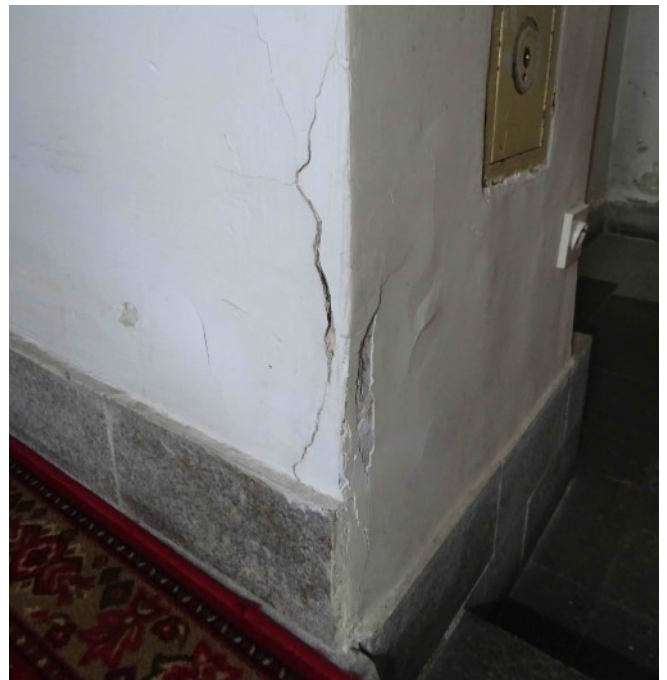
fot. 27. Kościół pw. św. Józefa Oblubieńca NMP w Koszalinie, uszkodzone tynki przyziemia.
