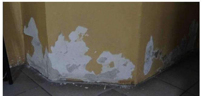
fot. 29. Kościół pw. św. Józefa Oblubieńca NMP w Koszalinie, zdeintegrowane i zasolone tynki przyziemia.
