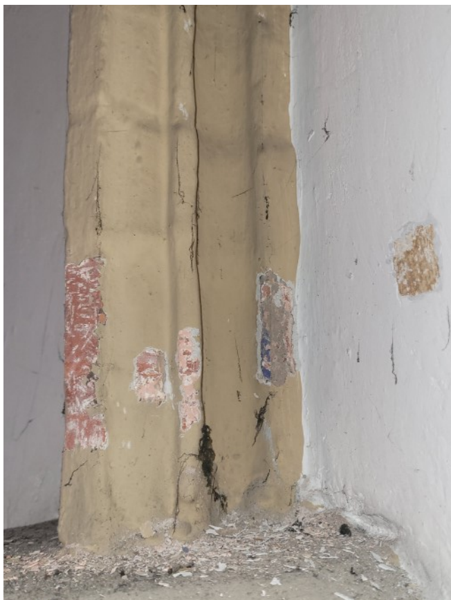
fot. 52. Kościół pw. św. Józefa Oblubieńca NMP w Koszalinie, spływ sklepienny, widoczne kolory czerwone i niebieskie żeber.
