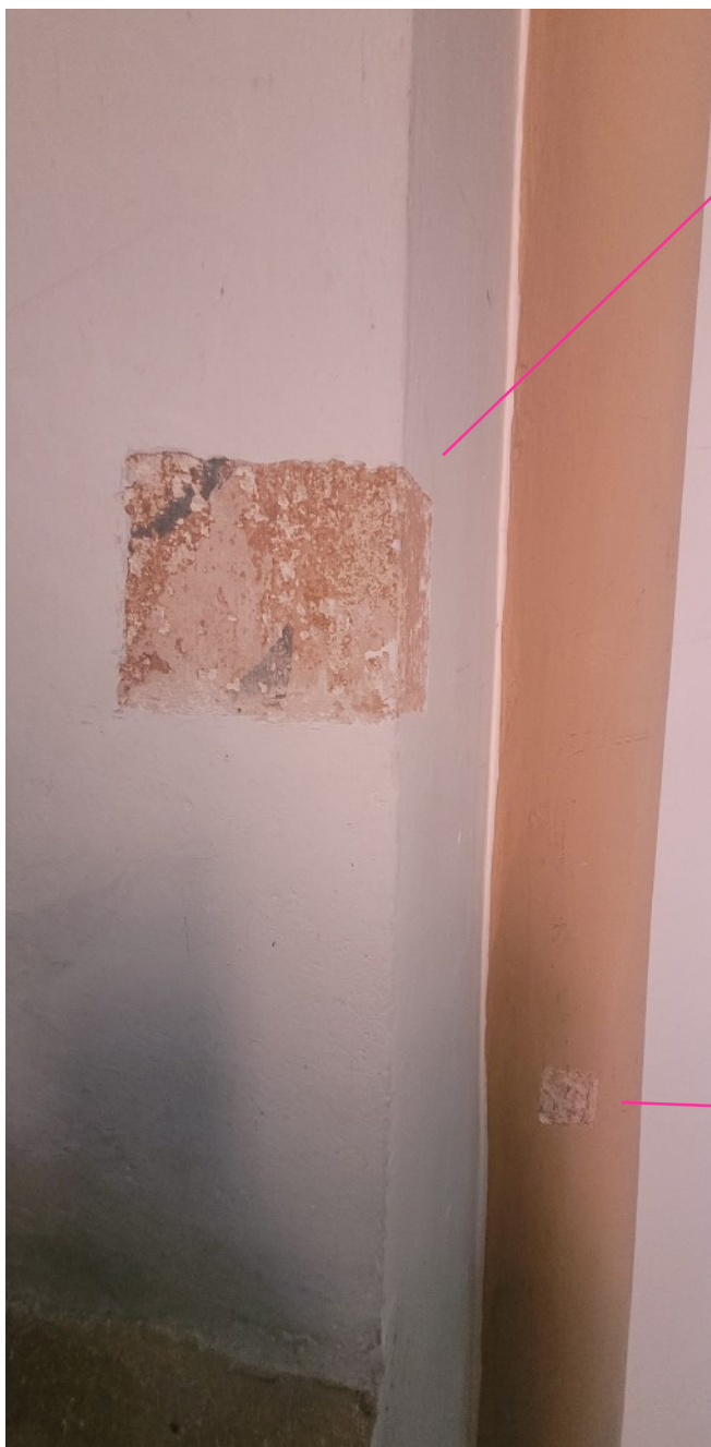
fot. 49. Kościół pw. św. Józefa Oblubieńca NMP w Koszalinie, odkrywka w glifie okiennym prezbiterium.
