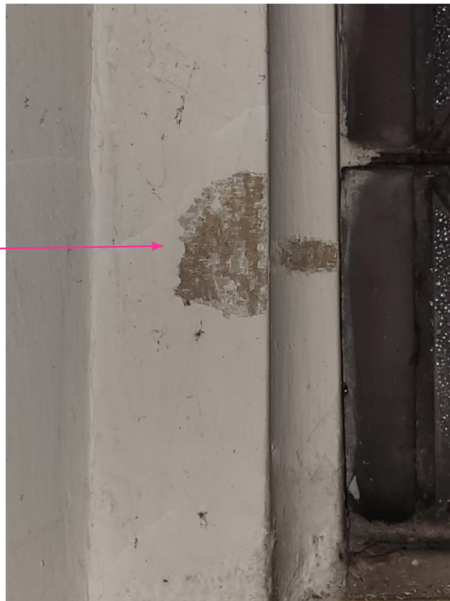
fot. 67. Kościół pw. św. Józefa Oblubieńca NMP w Koszalinie, glicf okienny nawy głównej.
