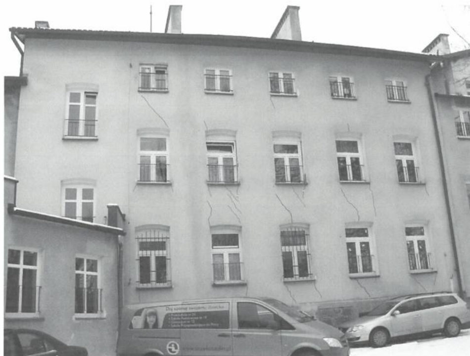
Fot. 3.8. Aktualny układ zarysowań północnej ściany nośnej budynku internatu
