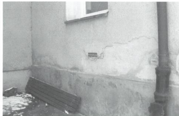
Fot. 3.10. Aktualny charakter zarysowań i innych uszkodzeń podłużnej ściany wschodniej sali sportowej Specjalnego Ośrodka Szkolno-Wychowawczego w Koszalinie
