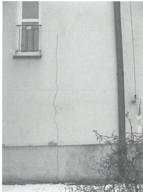
Fot. 3.3. Pionowe zarysowanie południowej ściany nośnej ewakuacyjnej klatki schodowej
