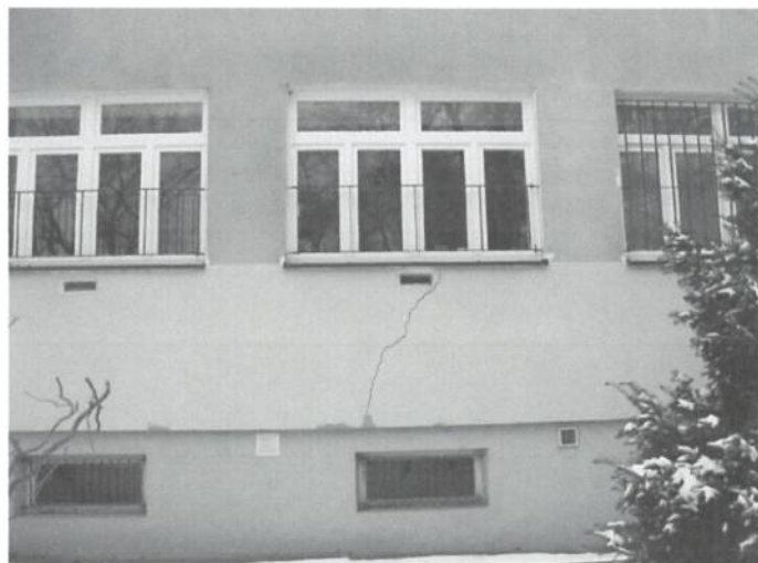
Fot. 3.4. Ukośne zarysowanie podokiennego pasa ściany nośnej wschodniej elewacji budynku dydaktycznego
